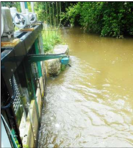
Crue juin 2018 relevés terrain
