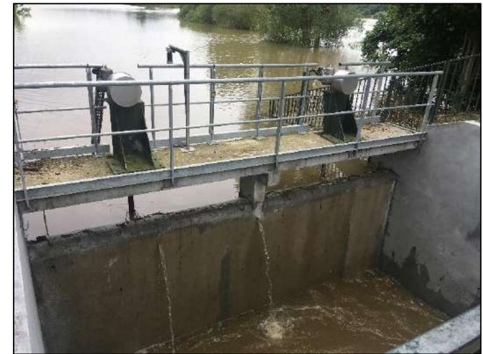
Crue juin 2018 relevés terrain
